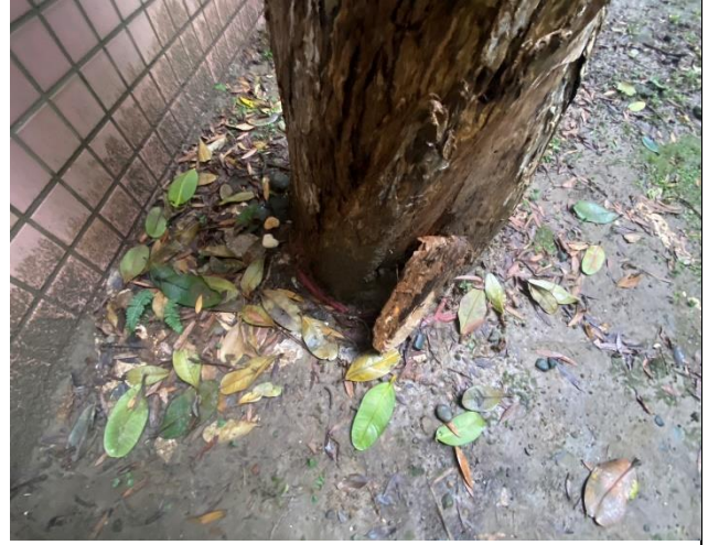
樹皮剝落、土球內塑膠繩未移除
