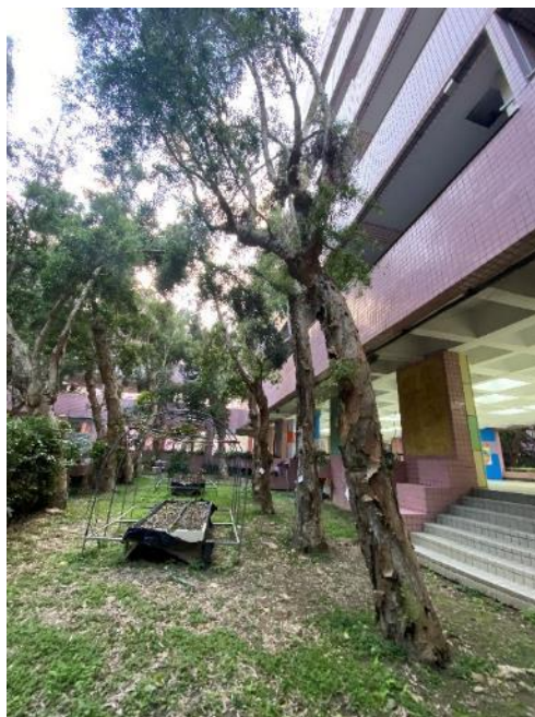
樹木於出入口阻礙動線，樹體傾斜
