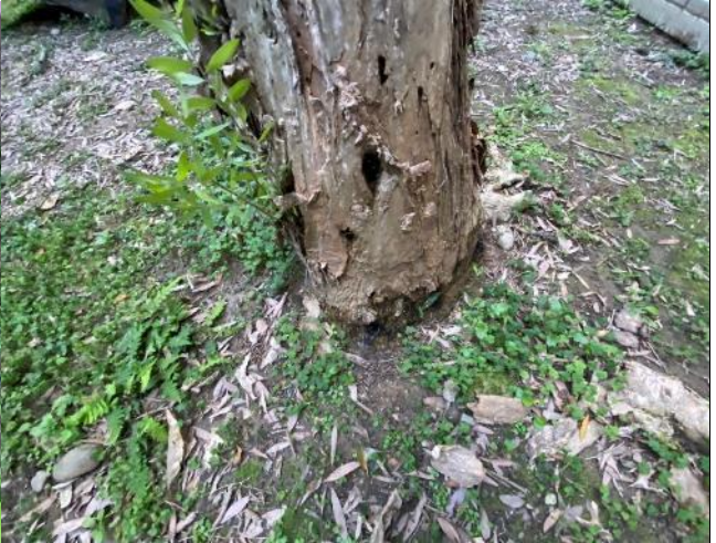
主幹傷口腐朽
