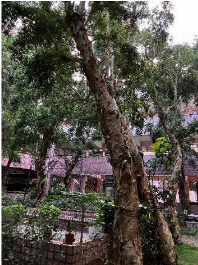
樹體傾斜及腐朽
