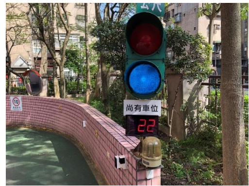
地下停車場車位計數器
