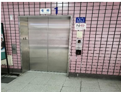
行政大樓無障礙電梯
